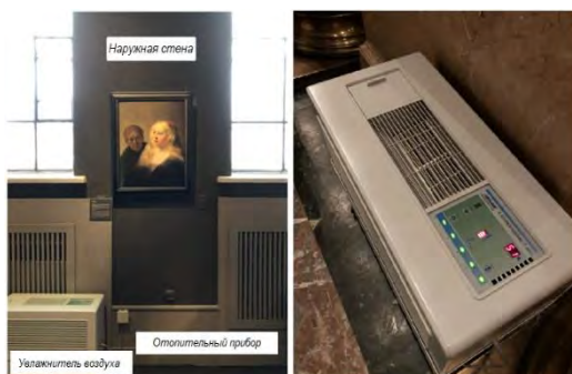
Рис. 2. Пушкинский музей. Размещение инженерного оборудования в картинной галерее.
