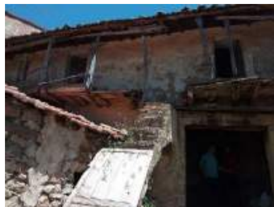
Рис 12 Фотография кабийского дома в деградационном состоянии. Разрушенная лестница Источник: https://www.facebook.com/observalgerie
