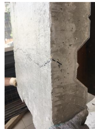
Рисунок 3.63 – Поперечная трещина в плите
