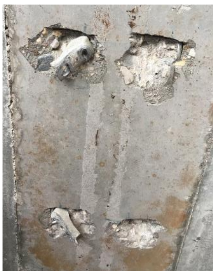
Рисунок 3.39 – Разрушение образца вследствие деформации упоров
