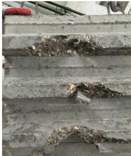
Рисунок 3.77 – Выкол упора из бетонного ребра вследствие продавливания
