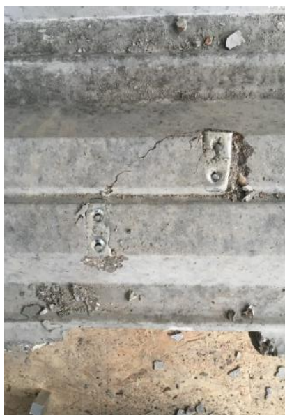
Рисунок 3.57 – Продольно-поперечные трещины в гофре
