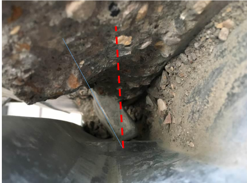
Рисунок 3.70 – Деформация анкерного упора
