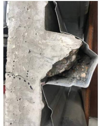
Рисунок 3.78 – Поперечные трещины в плите
