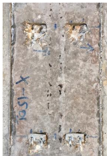
Рисунок 3.40 – Нижняя пара упоров вышла из строя вследствие вырыва дюбелей из основания
