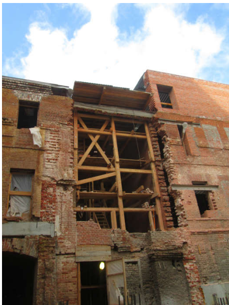
Рисунок 3.19 – Состояние стен на начальном периоде реконструкции
