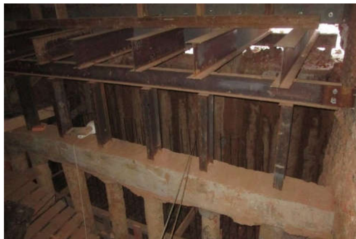
Рисунок 1.12 – Реконструкция «Дома купца С. Д. Лисицына – В. Д. Емелина, во флигеле которого 1 (13) февраля в 1873 г. родился певец Ф. И. Шаляпин» в г. Казани, 2017 г.
